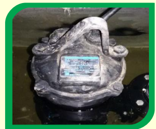
EFFLUENT PUMP & JET AERATOR
